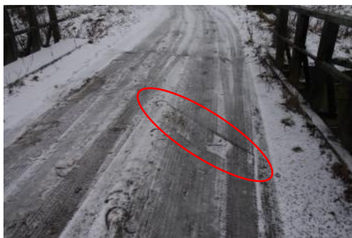
Fotografia 12 Brakujące deski nawierzchni płyty mostu
