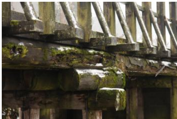
Fotografia 11 Przegniłe belki nośne
