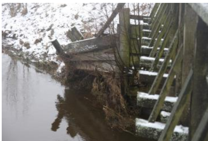
Fotografia 8 Uszkodzone skrzydło od strony wsi Grądy
