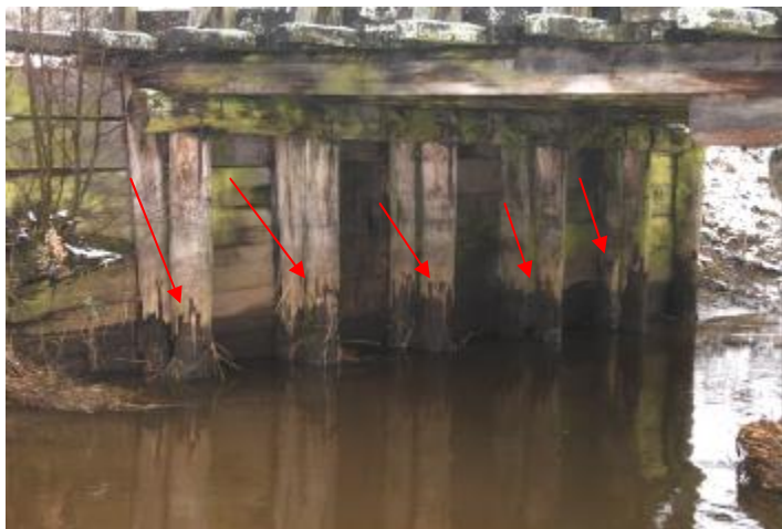
Fotografia 10 Uszkodzone słupy przyczółka
