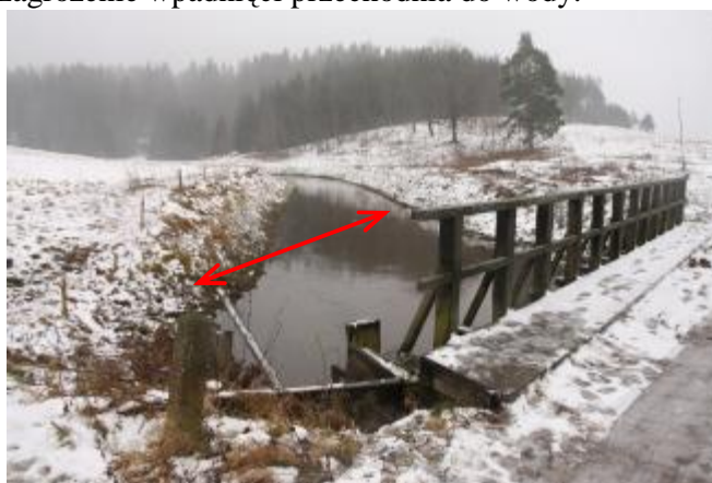
Fotografia 3 Brak poręczy na dojściu do mostu
