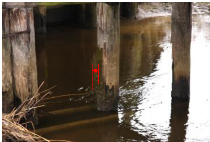
Fotografia 9 Uszkodzone słupy filara
