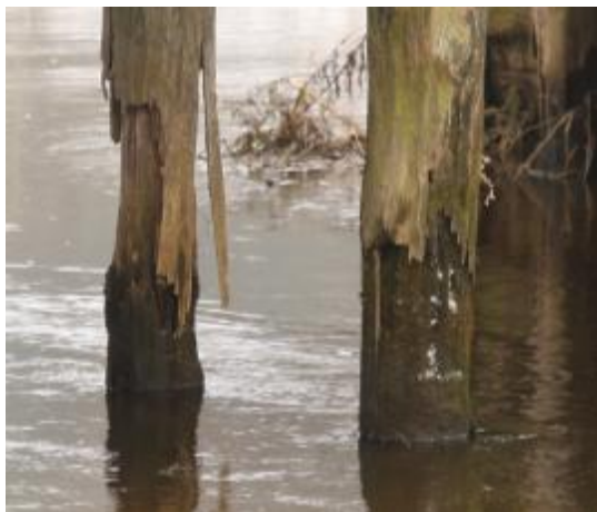
Fotografia 1 Uszkodzone pale filara
