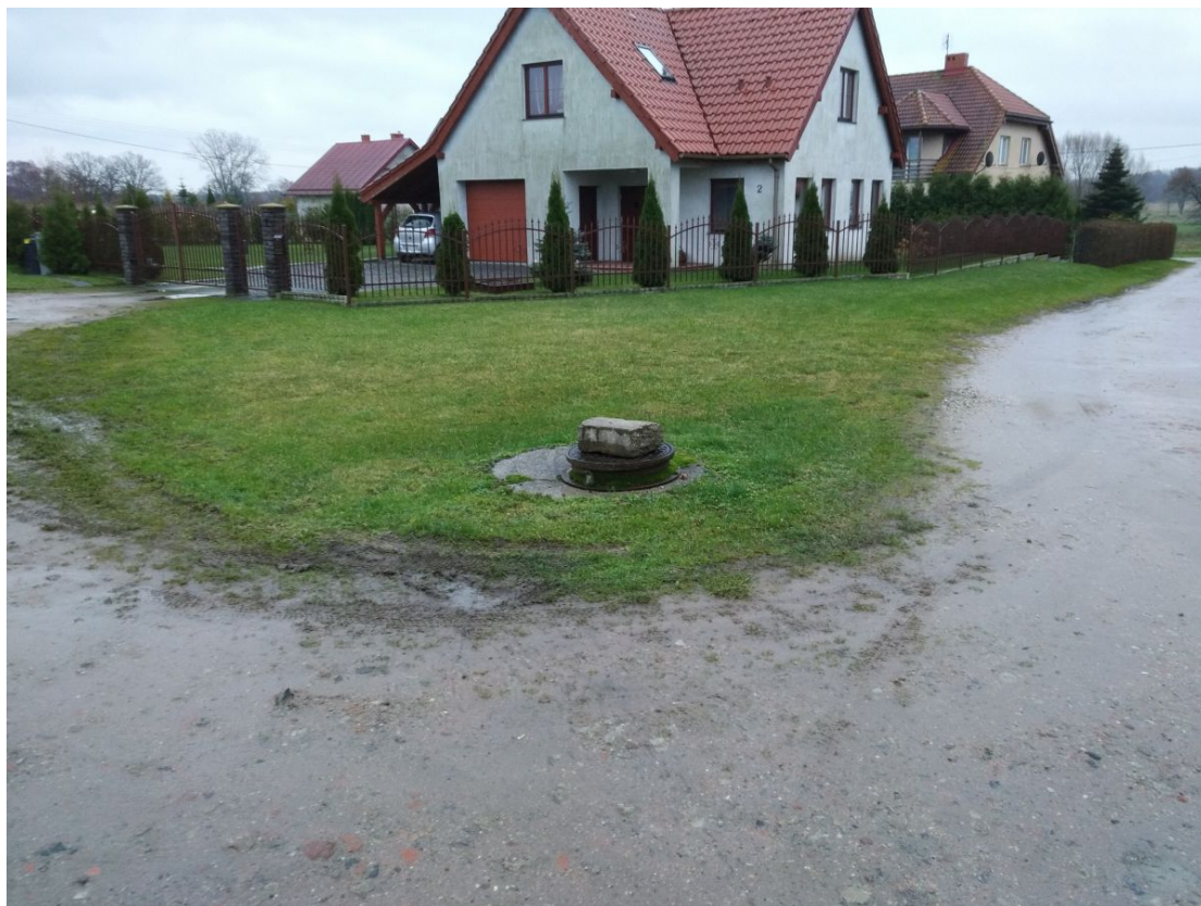
Fot. 3. Widok zwieńczenia studni kanalizacji sanitarnej niedostosowany wysokościowo do sąsiadującego terenu na skrzyżowaniu ulicy Brzozowej i Wiśniowej.
