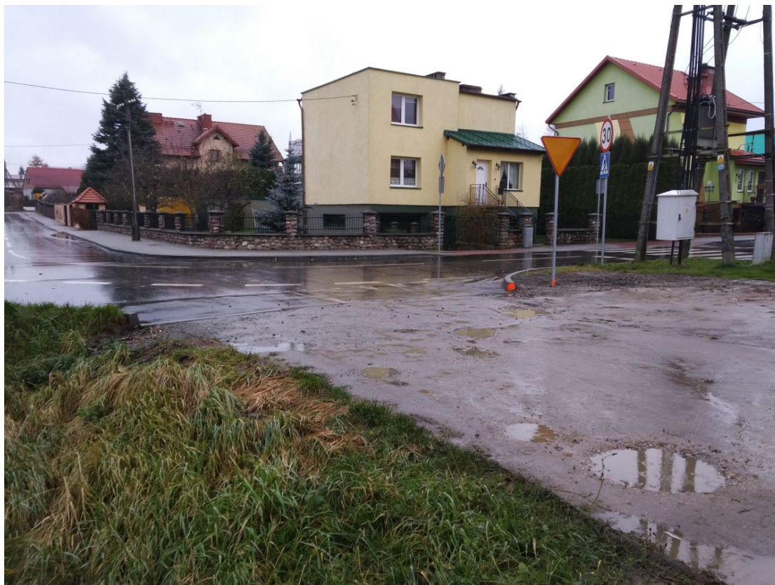
Fot. 1. Widok początku analizowanego ciągu ulic, tj. skrzyżowania ulicy Brzozowej z ulicą Sadową. Widoczna jest zniszczona i nierówna nawierzchnia niezwiązana z kruszywa.
