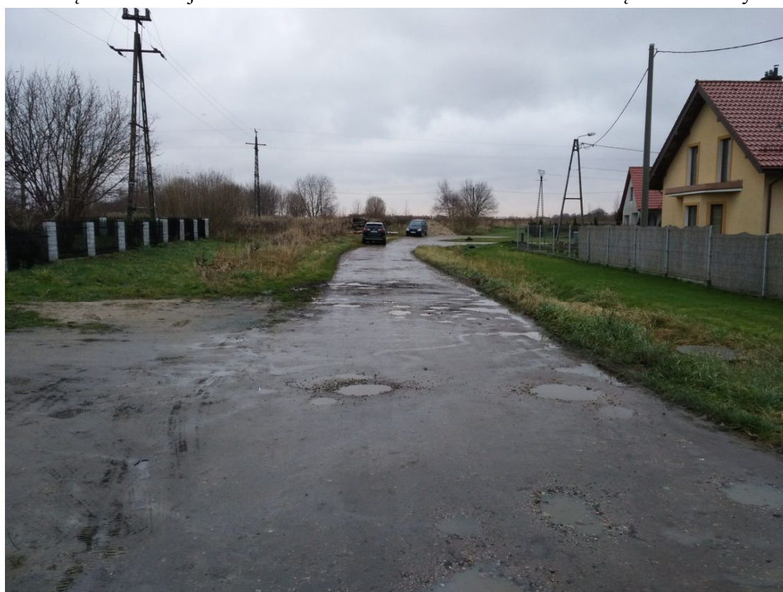
Fot. 2. Widok ogólny ulicy Brzozowej. Widoczna jest zniszczona i nierówna nawierzchnia niezwiązana z kruszywa.
